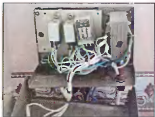
Так выглядит самодельный прибор, обеспечивающий автоматический режим работы насоса
